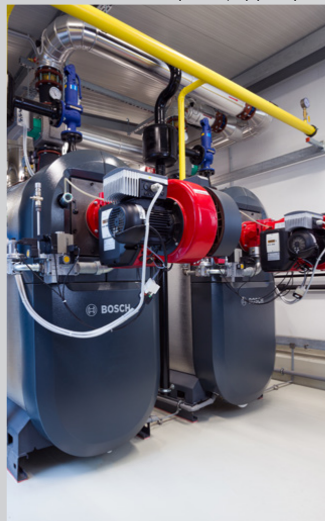
Plinski kondenzacijski kotli v podjetju LIV Systems
